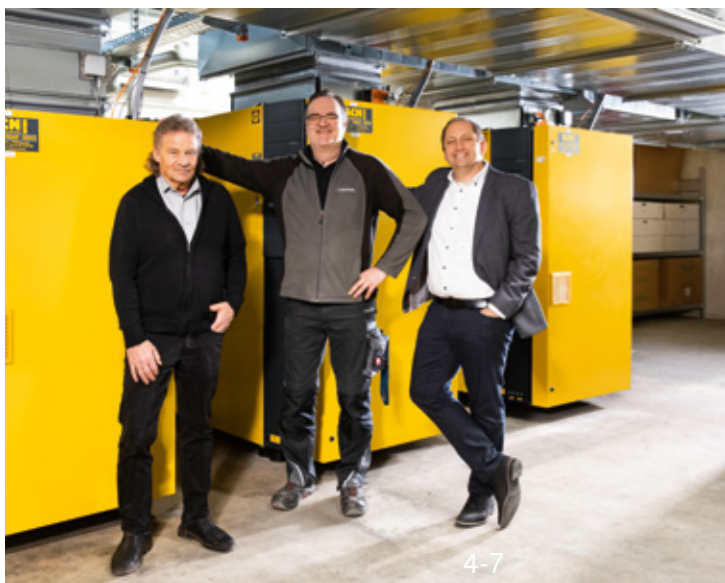
N. Winter (ANC-Kompressoren), Andreas Nittke (Gruppo Marbach) e Marcel Härtwig (KAESER) sono molto soddisfatti della nuova stazione d'aria compressa.
