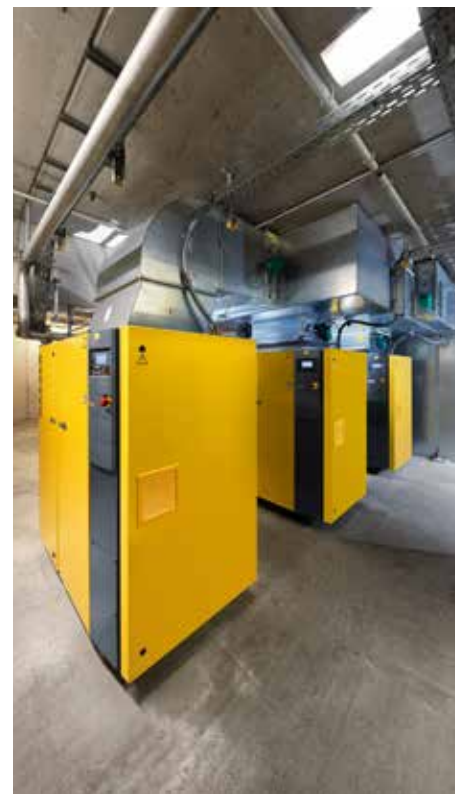
La nuova stazione di aria compressa è parte essenziale del ben riuscito piano di risparmio energetico.
